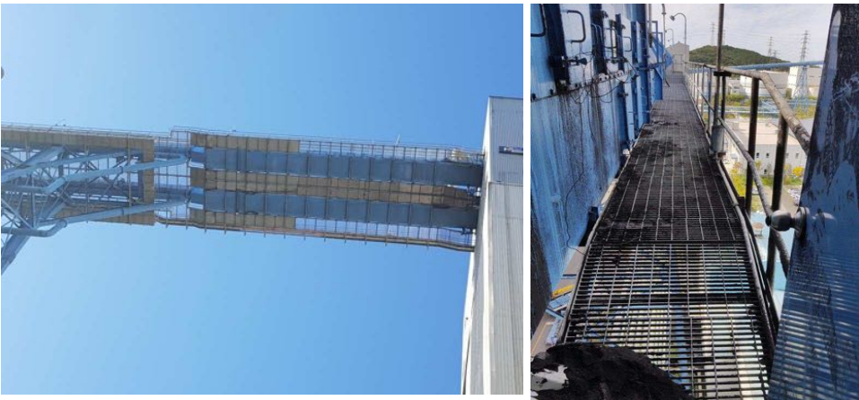
〈높은 곳에 위치한 컨베이어 벨트, 허술한 바닥〉 22)
