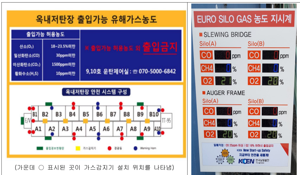
[그림 106] 옥내저탄장 가스감지기 설치 위치(좌: 당진발전본부)와 옥내저탄장 출입구에 설치된 가스농도 전광판(우: 영흥발전본부)
