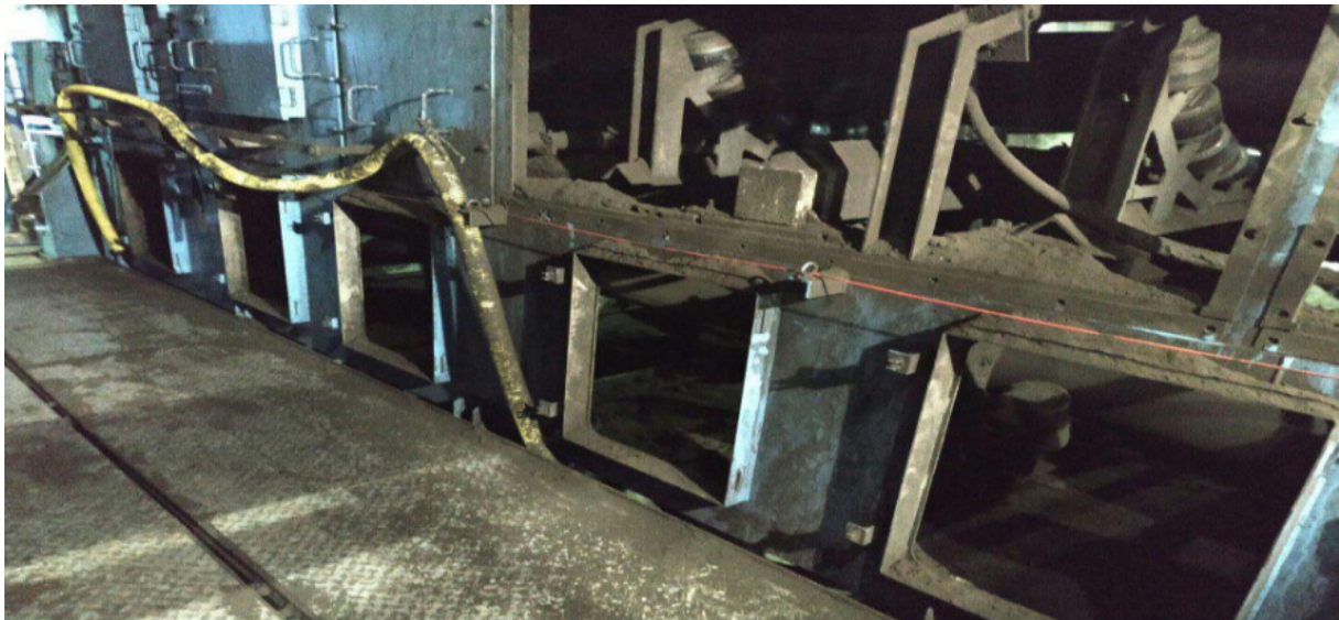
[그림 1] 고인이 사고를 당한 공기부상형 벨트컨베이어 밀폐함 점검구 사진
