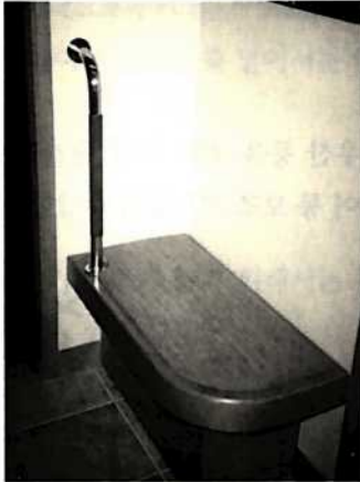
그림 44. 현관에 설치된 보조의자와 핸드레일
