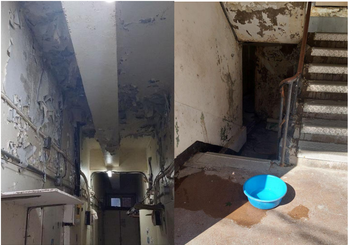
(사진 왼쪽) 동자동 윤영주님이 이야기한, 전에 살았던 지하층 쪽방 내부. 습기로 쪽방 복도의 벽지와 페인트가 떨어져 나갔다. 사진 이동현 (사진 오른쪽) 동자동 윤영주님이 이야기한, 전에 살았던 지하층 쪽방 내부. 빗물을 머금은 벽체는 햇빛이 쨍쨍한 맑은 날에도 물을 떨군다. 사진 이동현
