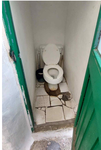
〈좁고 환기에 취약한 화장실〉
